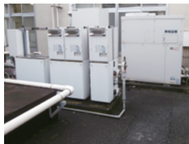
レンタフマルチの後ろは小型ガスコージェネレーションシステム。その廃熱を利用し、レンタフマルチとともに給湯を行う。
