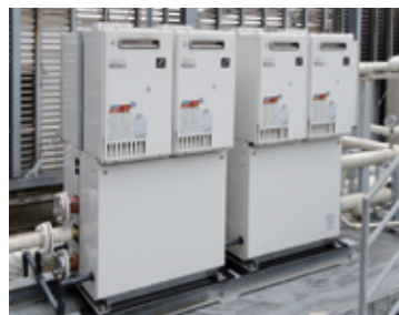
レンタフマルチ (32号×8台)
